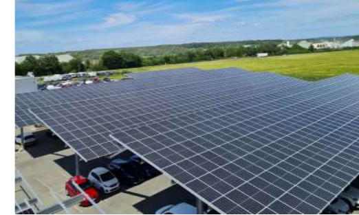
TECHNIQUE SOLAIRE Essarts-en-Bocage (85) Marché de travaux 2.2 MWc - 740 places couvertes
